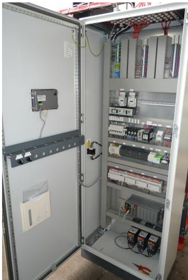
Obr. 6 - Zapojení řídicích automatů v rozvodné skříni kotle. PLC WinPAC je v druhé řadě odspodu, PLC Siemens v třetí řadě odspodu.
